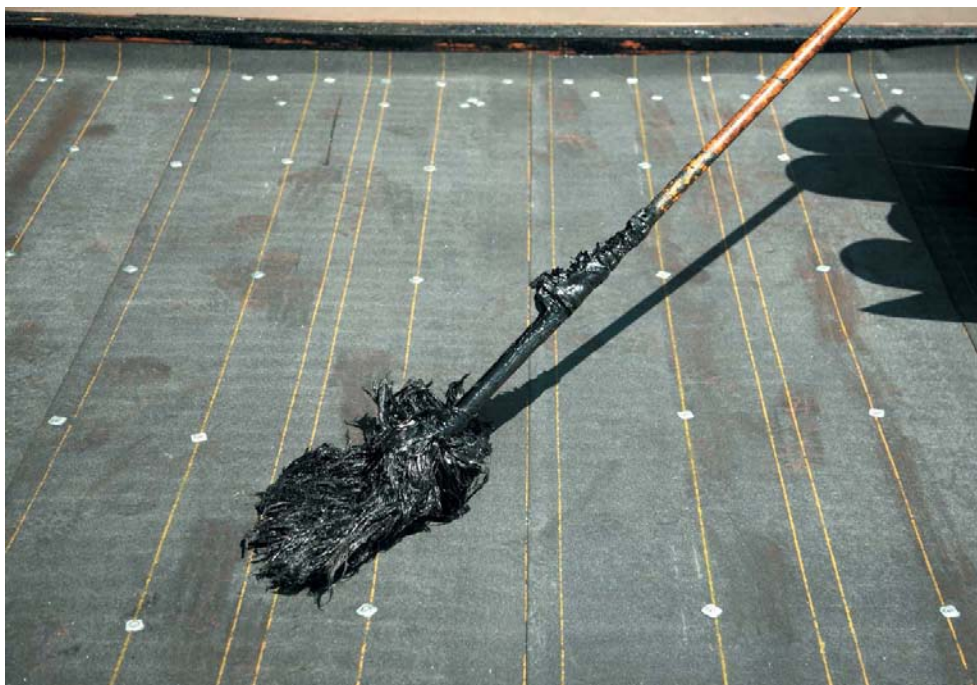
Рис. 13. Рубероид — материал крыши жилых многоэтажек — постоянно нуждается в ремонте
