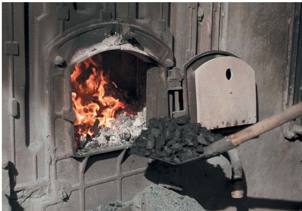
Рис. 34. Котел на угле
